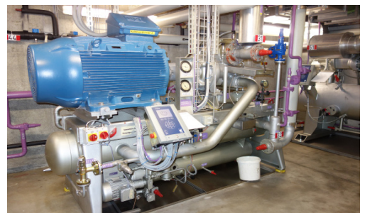
Druckluftanlage Leisi AG
