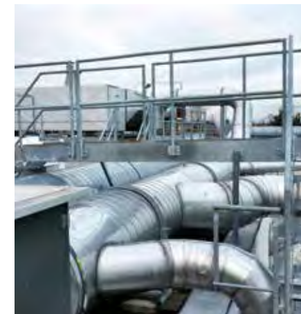
Pinch-Technologie für Givaudan, Kostensenkung durch umfassende Energieanalyse
