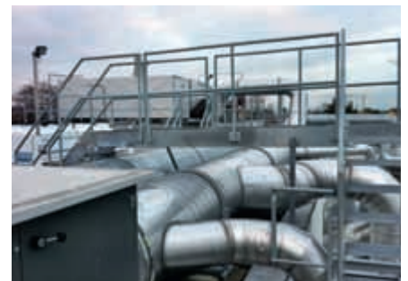
Givaudan Dübendorf: Kostensenkung durch umfassende Energieanalyse (Pinch-Technologie)
